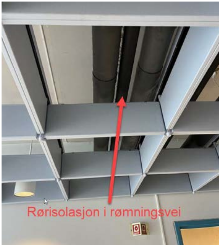
Figur 16: Tiltak 37.2 Vurdering av brannklasse på rørisolasjon
