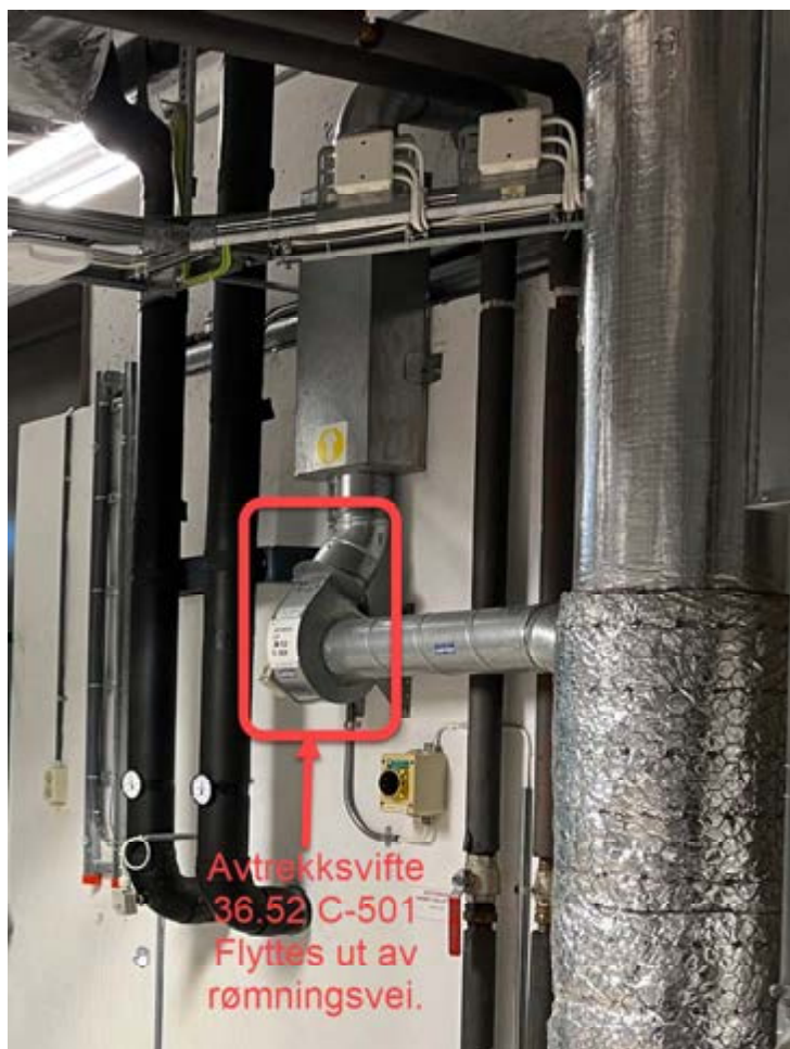
Figur 13: Tiltak 36.4 Flytting av avtrekksvifte ut fra rømningsvei
